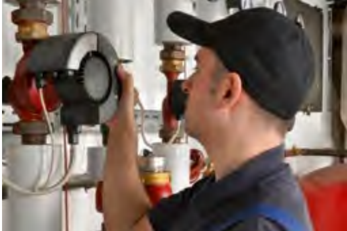
Kostensenkung durch neue Pumpen
