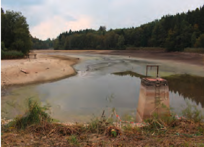
Sanierungsfall Langer Weiher in Deixlfurt
