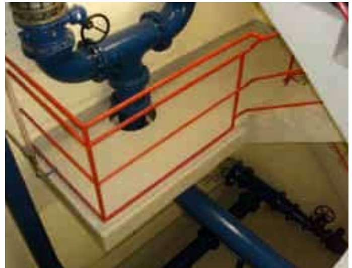
Hygiene ist das höchste Gut bei der Trinkwasserversorgung
